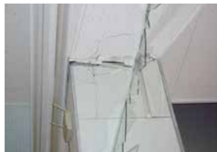
地震による従来型防煙垂壁(ガラス製)の破損の様子
